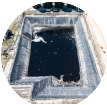
Traitement des lixiviats
